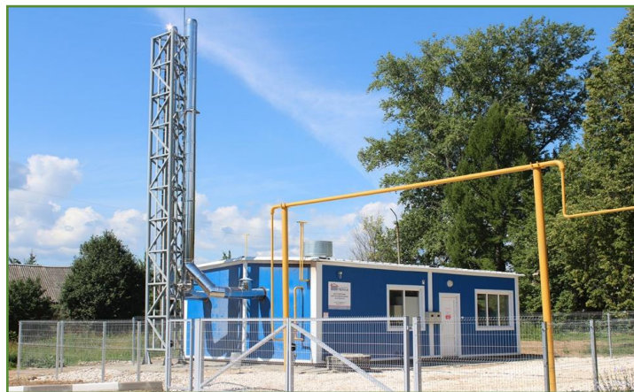
Рис. 2. Газовая блочно-модульная котельная
