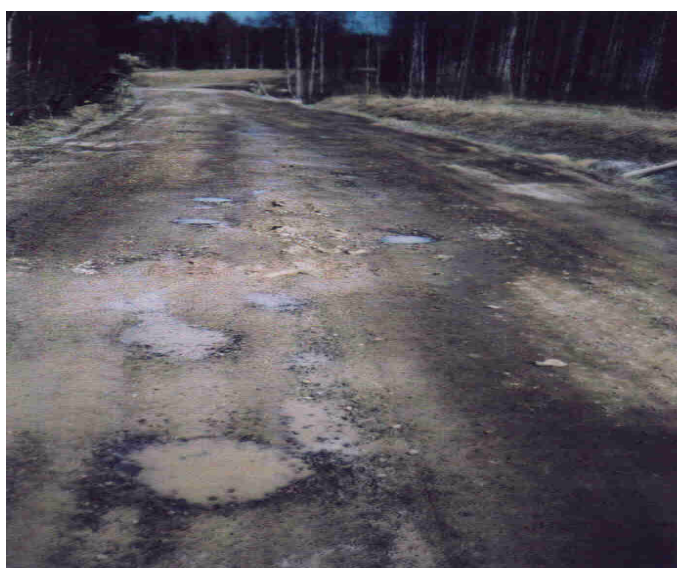
Рис. 3. Состояние дороги через 5 лет после ремонта традиционным способом с традиционными материалами
